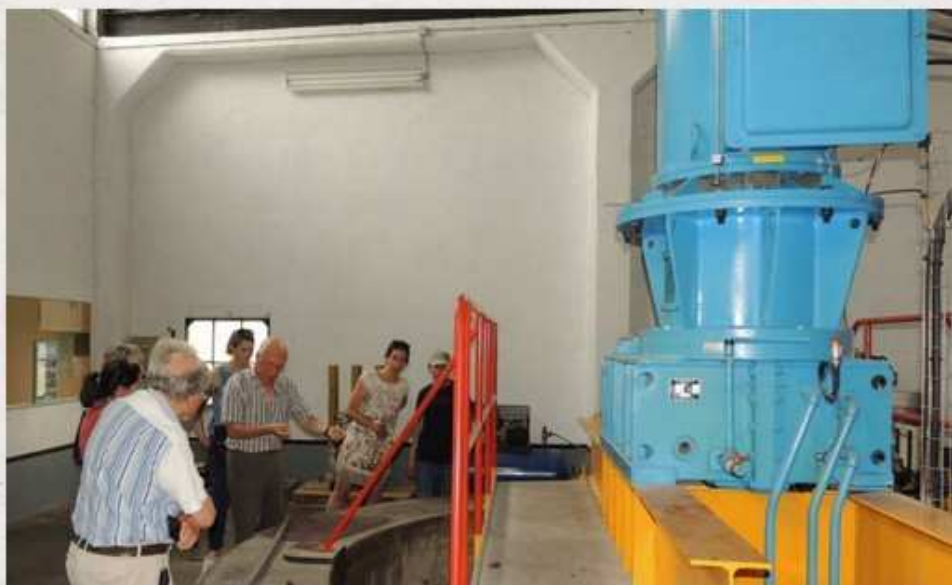
Au bout de leur axe, les turbines de trois tonnes tournent au ralenti en raison du faible débit du Doubs. Photo Progrès/Éric VIOLET
