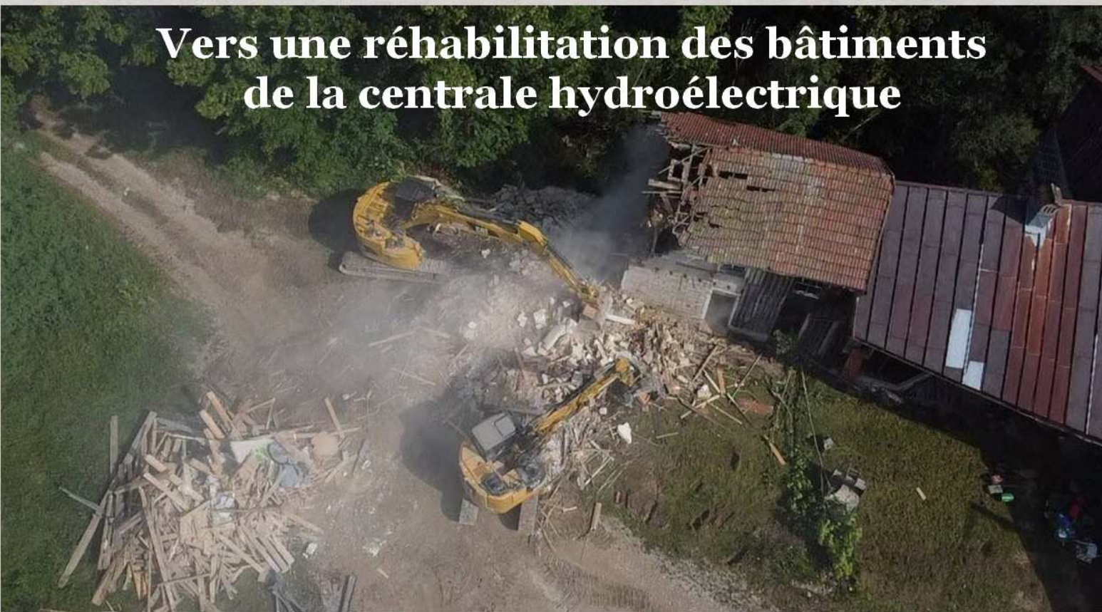
Le chantier de réhabilitation de la centrale a commencé il y a quelques mois. Photo DR
