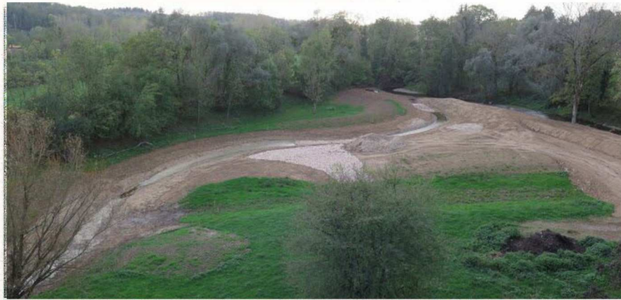
Les travaux de reméandrage de la Vallière ont démarré en octobre. La rivière, que l'on aperçoit sur la droite de la photo, va retrouver son tracé d'origine, davantage sinueux. Photo Progrès/Élodie CASTELLI
