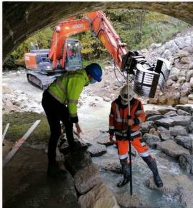
Le PNR du haut Jura a réalisé des travaux sur un seuil du bassin-versant du Tacon, pour restaurer sa continuité écologique.
