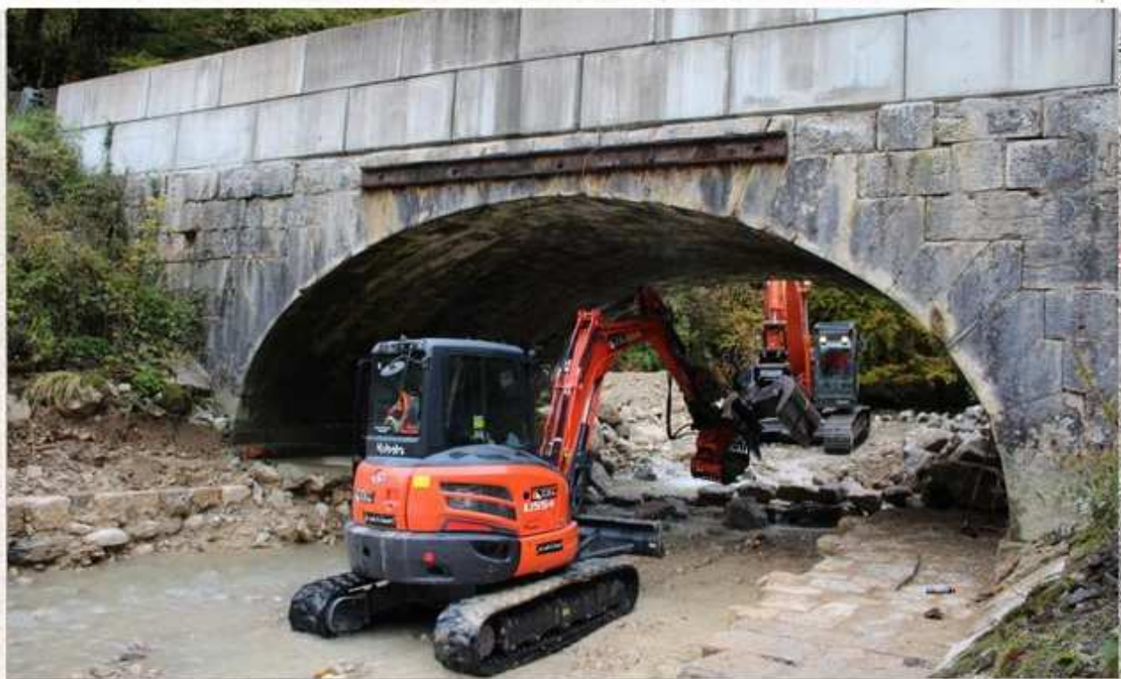
Le chantier sous le pont de l'Isle a réellement débuté le 13 octobre et a duré un peu plus d'un mois. Archive Progrès/Laëtitia COURTI
